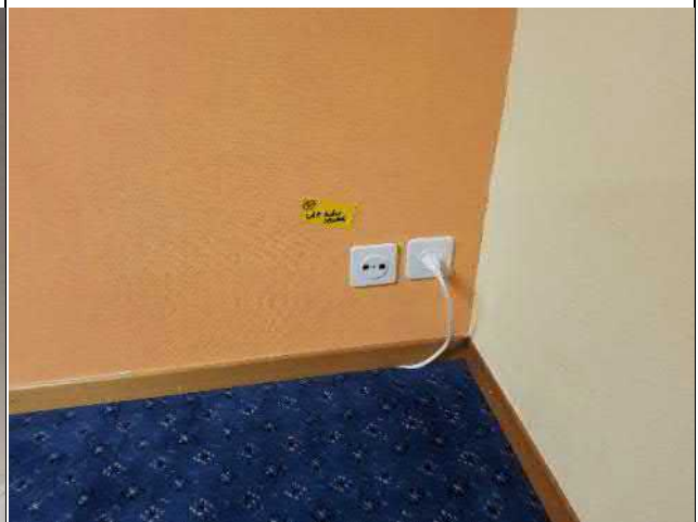
022-01 Standort: Dachgeschoss Raum 4/5 (Verdacht)
