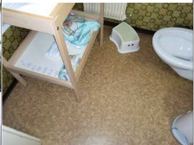
008-08 Standort: Dachgeschoss Raum 2 (Bad)
