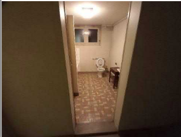
070-05 Standort: 1. Untergeschoss Bad
