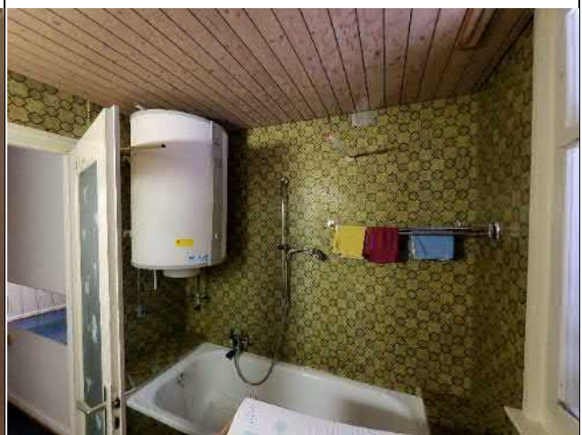
011-02 Standort: Dachgeschoss Raum 2 (Bad)
