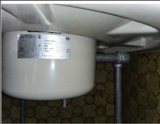
003-03 Standort: Dachgeschoss Raum 2 (Bad)
