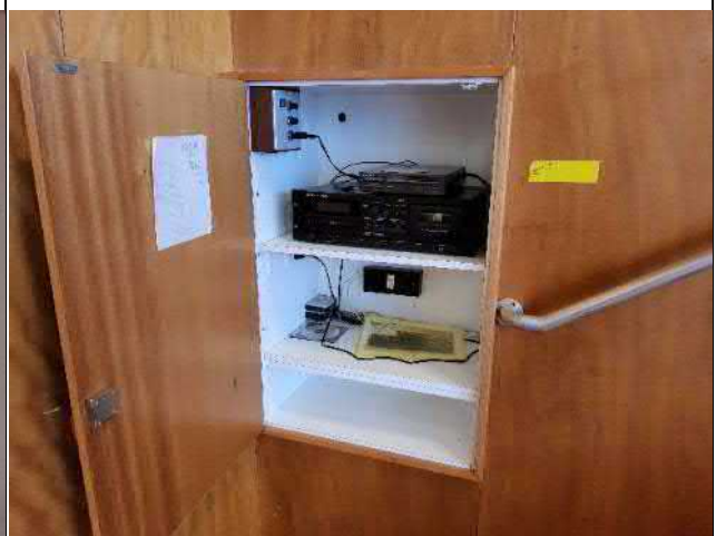
034-01 Standort: Erdgeschoss Turnhalle (Verdacht)
