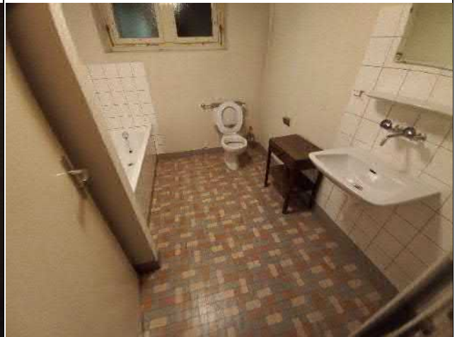
070-05 Standort: 1. Untergeschoss Bad
