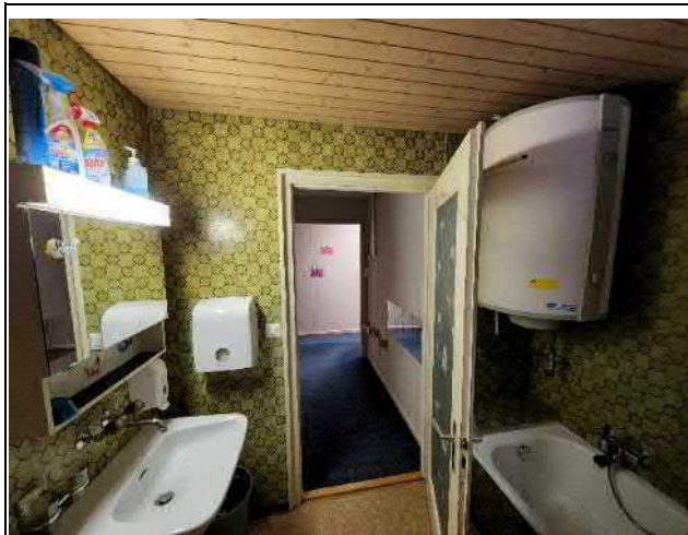
011-02 Standort: Dachgeschoss Raum 2 (Bad)
