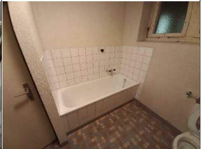
037-12 Standort: 1. Untergeschoss Bad
