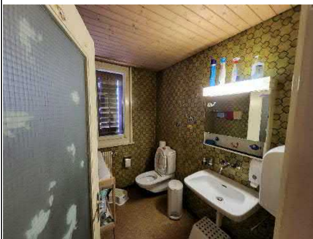
011-02 Standort: Dachgeschoss Raum 2 (Bad)
