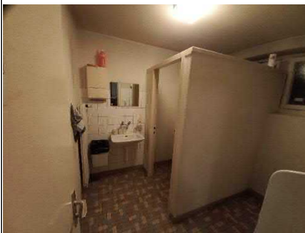
037-13 Standort: 1. Untergeschoss WC Herren
