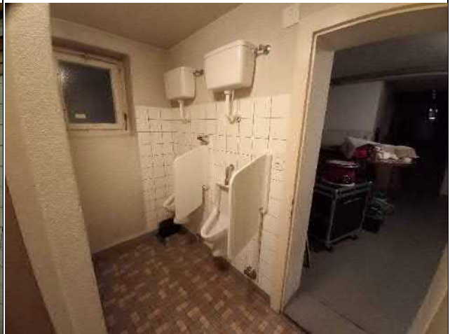
037-13 Standort: 1. Untergeschoss WC Herren
